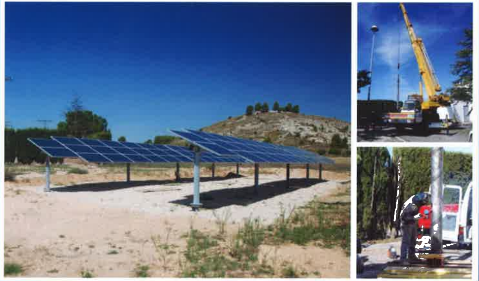
Figura 2. Prototipo de bombeo fotovoltaico para riego en pozo de la CGUAV (Alicante). El generador fotovoltaico está montado sobre un seguidor solar de un eje horizontal norte-sur. Detalle de los trabajos de adecuación del pozo e instalación de la bomba sumergida.
